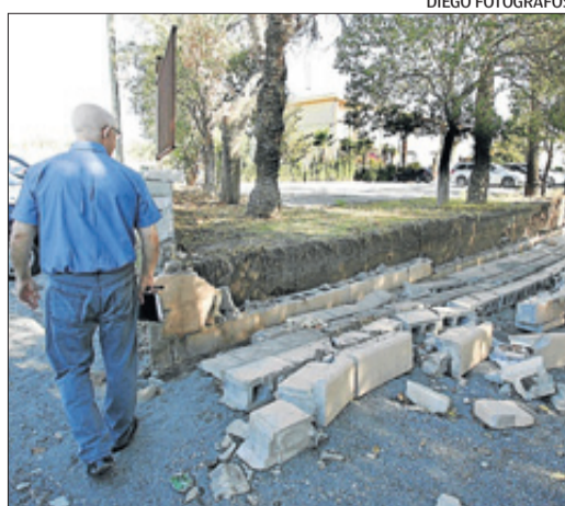
Imagen de la valla derrumbada.
